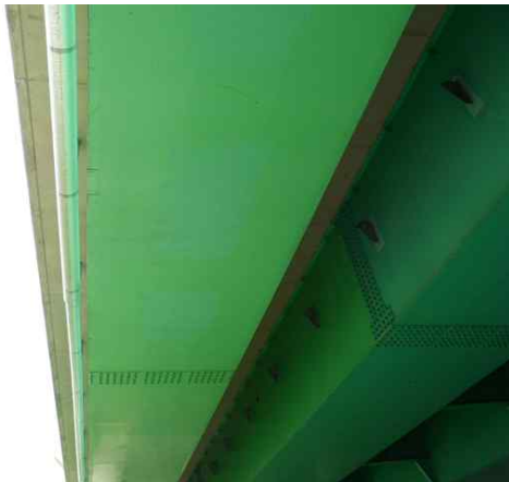
바닥판 하면 S2 상태양호
