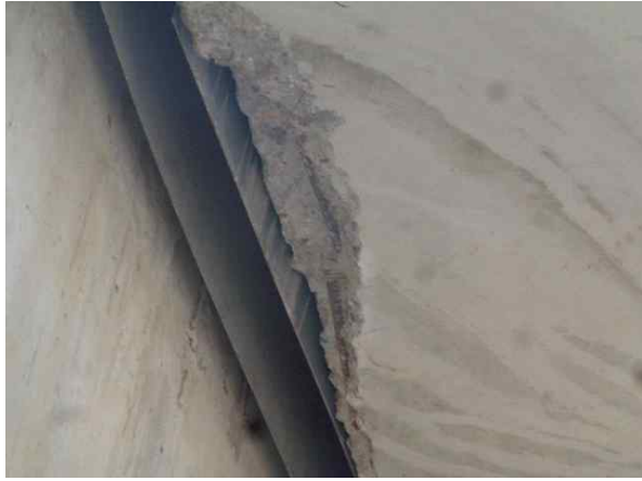
S4 파손 및 철근노출 (0.2m×1.0m)
