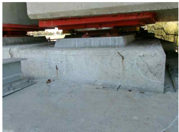
P4-Sh1 받침콘크리트 망상균열(1.5×0.3)
