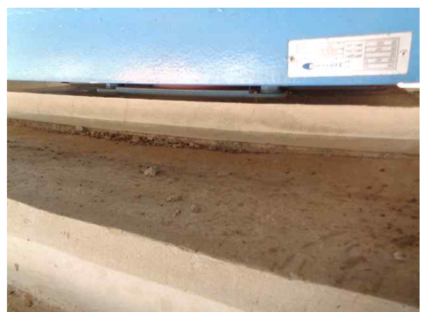
P5-Sh11 받침몰탈 균열 (0.1mm/0.2m×2EA)
