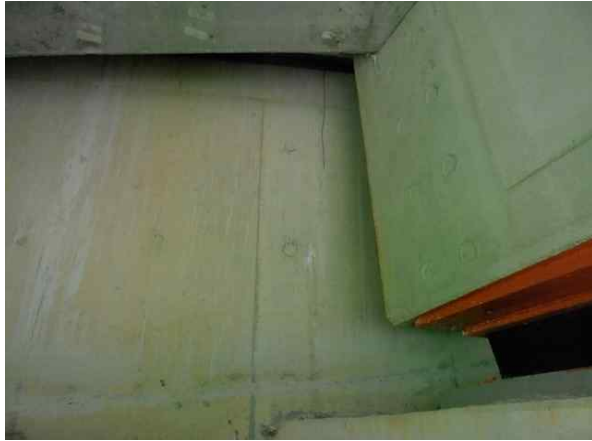
교대 A1 흉벽 균열(Cw=0.3mm이상)
