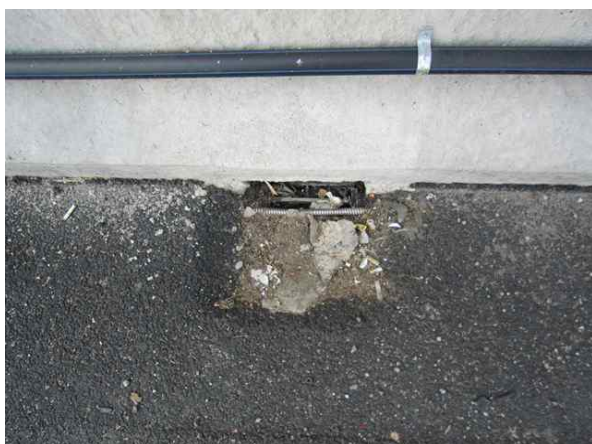
배수시설 S3 배수구 토사퇴적
