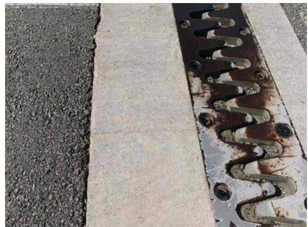
A1 후타재 균열(Cw=0.3mm미만)
