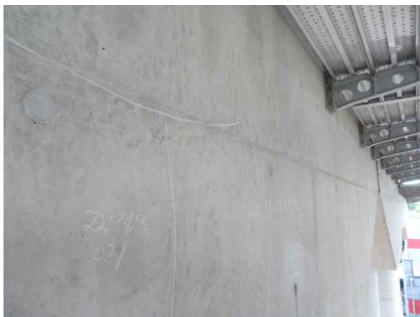
P6 코평부 균열(0.2mm/10.0m)
