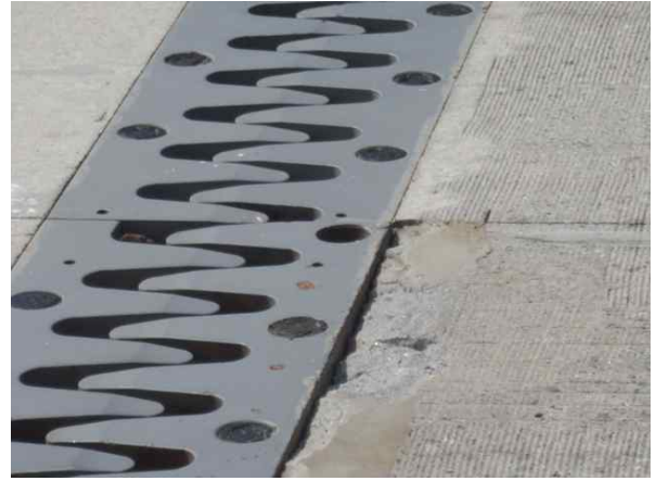
A2 후타재 파손(0.1×1.5), 본체 볼트 탈락(1EA)
