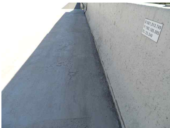
교면포장 S1 접속도로 포장박리(1.5×7.0)
