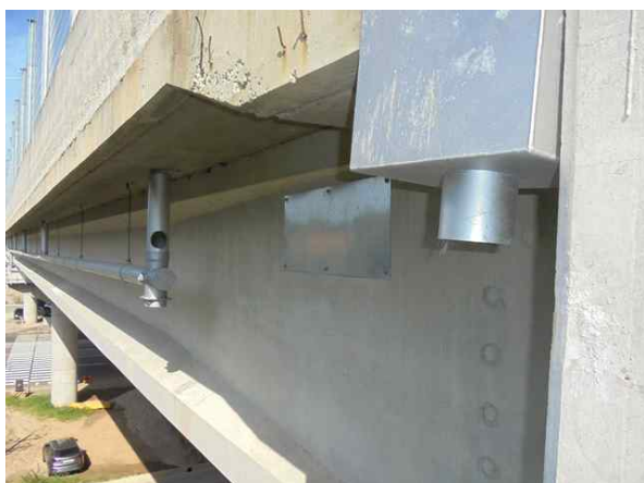
S1 A1측 배수관 탈락
