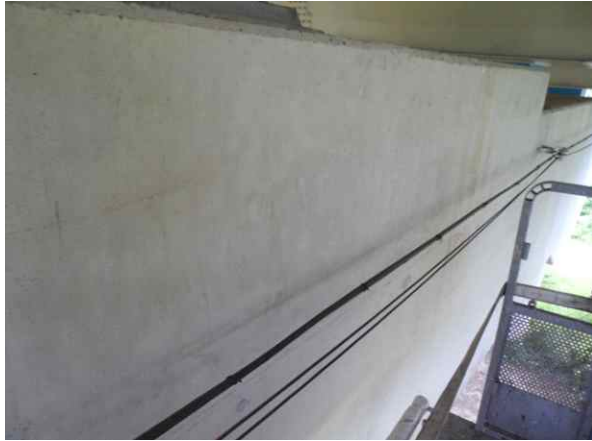
교각 P4 코핑부 망상균열(12.0×2.0)
