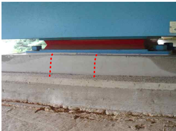
P5-Sh1 받침몰탈 균열(Cw=0.3mm미만)
