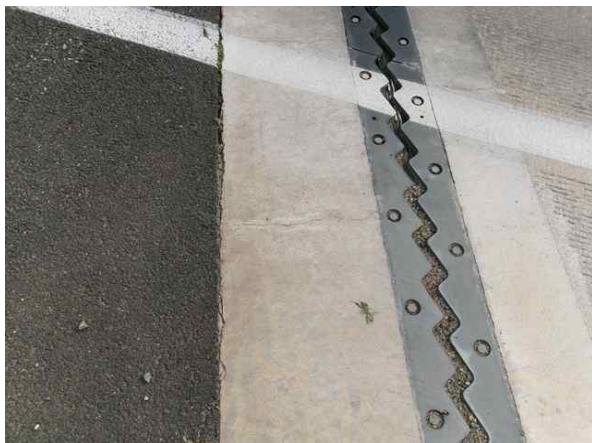
A2 후타재 균열(Cw=0.3mm미만)-서울방향
