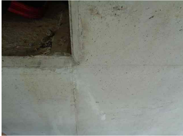
교각 P2 코핑부 균열( Cw=0.3\text{mm} 이상)
