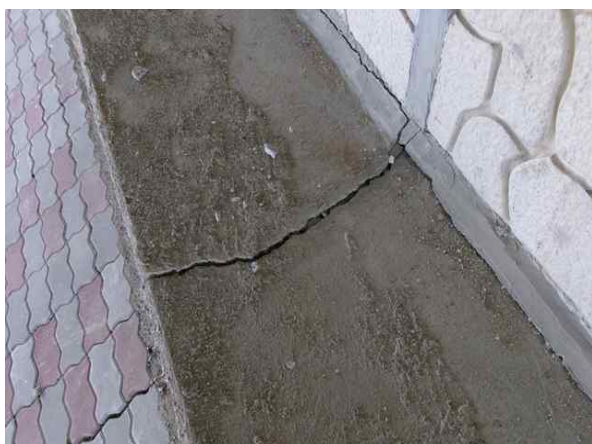
A2 법면 물탈 파손(0.1×1.5)
