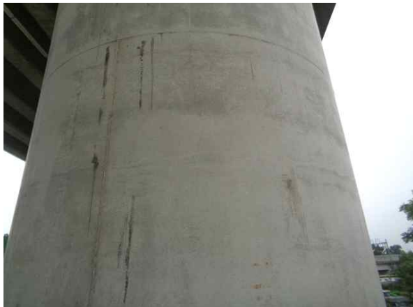
교각 P1 기둥부 균열(Cw=0.3mm미만)
