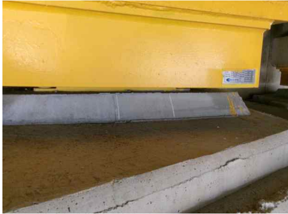
A1-Sh5 받침몰탈 균열(Cw=0.3mm미만)
