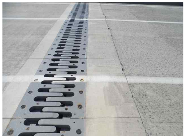
신축이음 A2 후타재 균열 (Cw=0.3mm미만)
