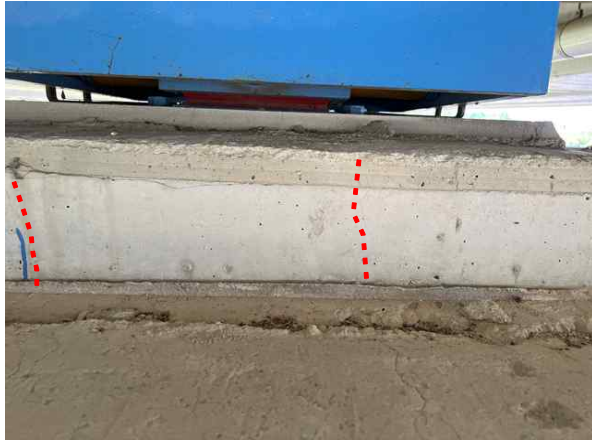
P5-Sh4 받침콘크리트 균열( C_w=0.3\text{mm} 미만)
