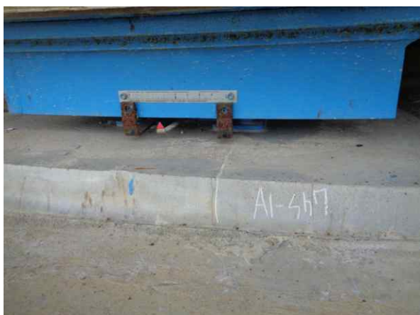
A1-Sh7 받침물탈 균열( Cw=0.3\text{mm} 미만)
