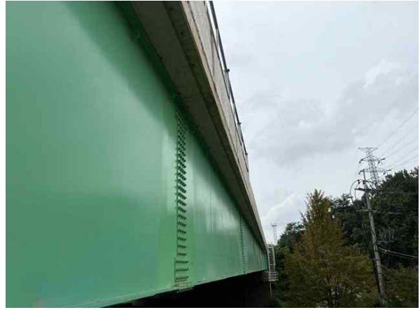
바닥판 하면 S1 상태양호
