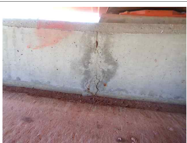
P35-Sh1 받침콘크리트 파손 (0.1m×0.3m×2EA)
