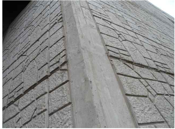
A1 보수부 재균열(Cw=0.3mm미만)-서울방향
