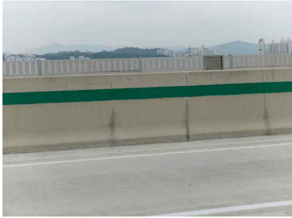
S4 중앙분리대 균열부 백태(0.2×1.0×10EA)
