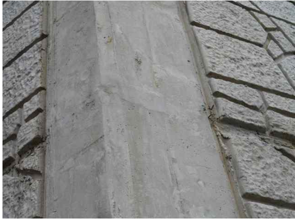
A1 보수부 재균열(Cw=0.3mm미만)-서울방향
