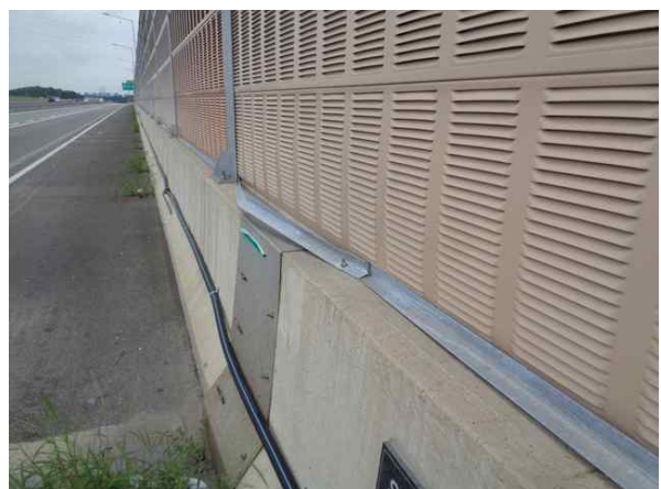
방호벽 S1 방음벽 파손(1EA)
