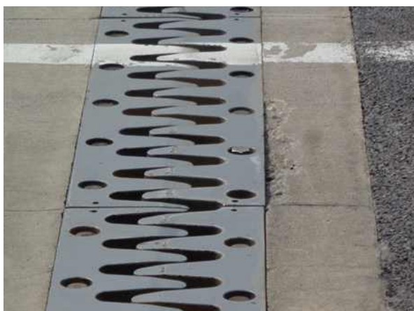
A1 후타재 파손 (0.2m×0.5m) - 22년 상반기
