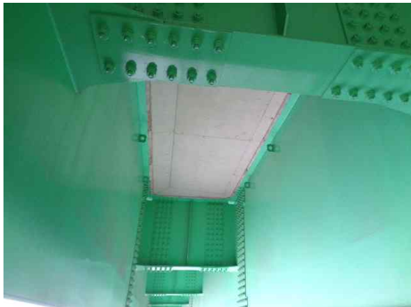
바닥판 하면 S3 상태양호
