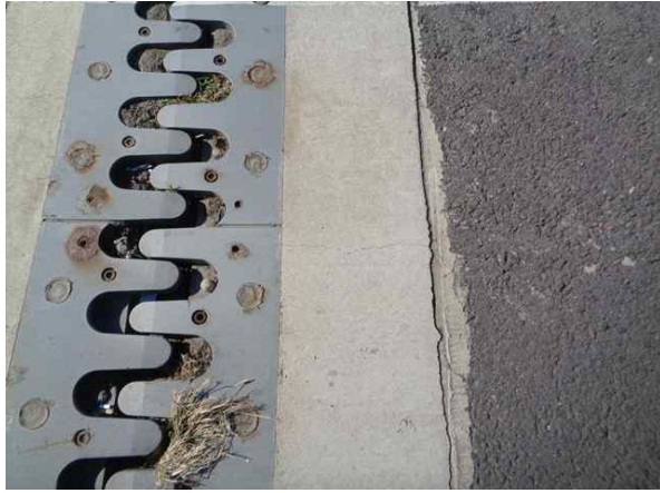
A2 후타재 균열 (0.2mm/0.3m×10EA)
