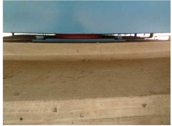
P5-Sh4 받침물탈 균열 (0.1mm/0.2m×2EA)
