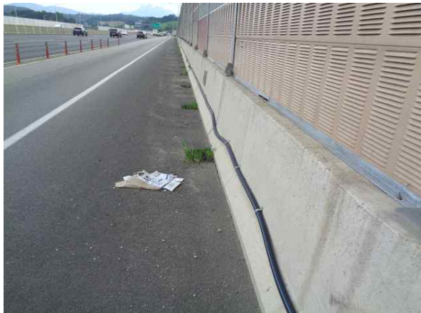
배수시설 S1 배수구 토사퇴적
