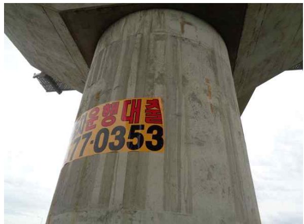
교각 P1 코핑부 파손(0.2×0.3)
