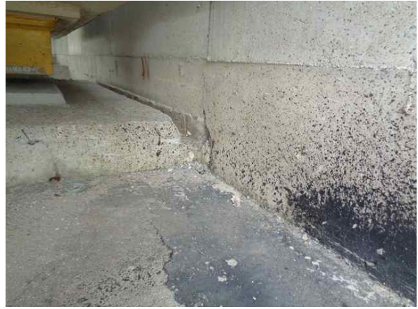
교대 A2 파손(0.1×0.1)
