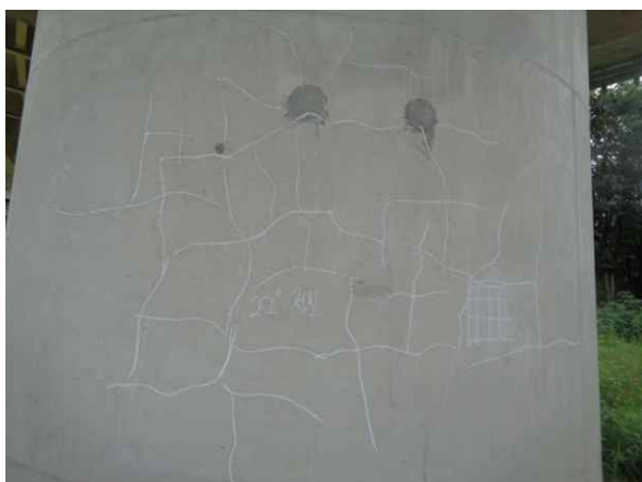
P1 기둥부 망상균열(8.0 × 2.0)
