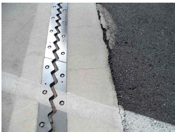
A2 후타재 균열(Cw=0.3mm미만)-문산방향
