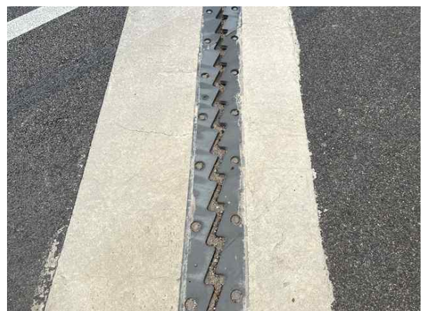
신축이음 A1 후타재 균열(Cw=0.3mm미만)
