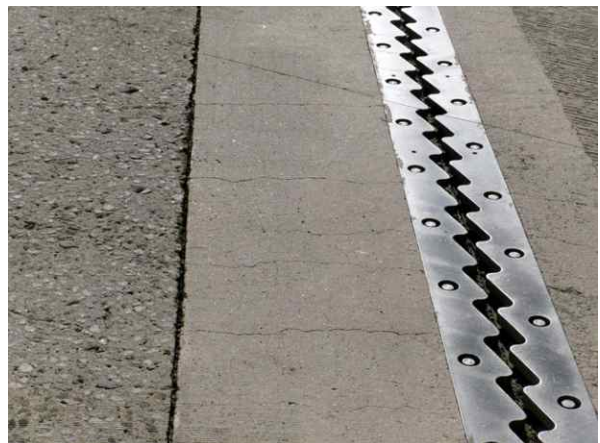
A1 후타재 균열(Cw=0.3mm미만)
