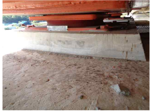
P5-Sh1 받침물탈 균열 (0.1mm/0.2m×2EA)
