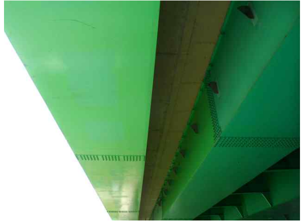
바닥판 하면 S4 상태양호
