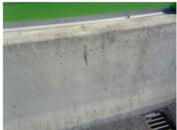
S3 방호벽 균열부 (0.3mm/1.1m)
