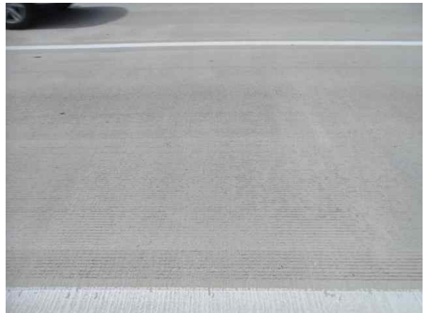
S3 교면포장 망상균열(60.0×3.0)
