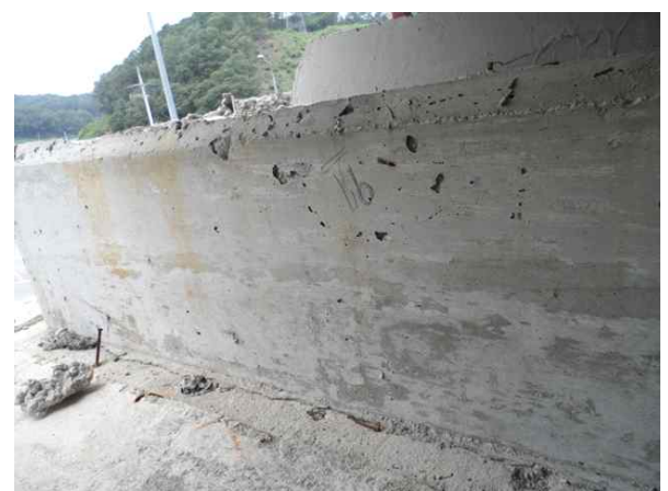
P3-Sh1 받침콘크리트 균열 ( C_w=0.3\text{mm} 미만)
