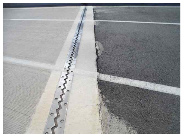
A2 후타재 균열(Cw=0.3mm미만)-문산방향
