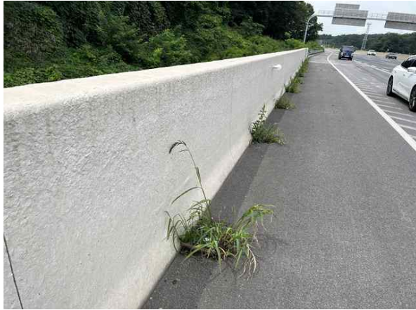
배수시설 S1 배수구 토사퇴적
