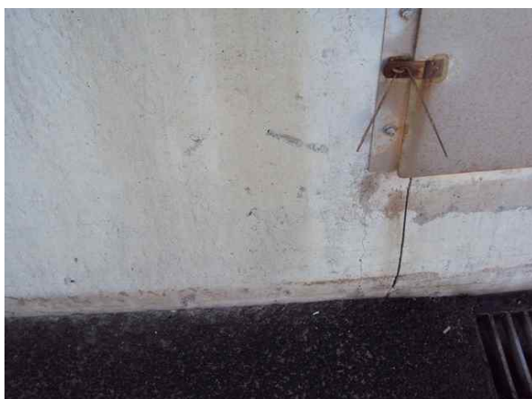
S4 방호벽 균열 (0.2mm/0.5m)
