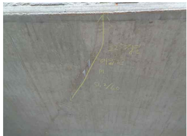
P1 코평부 균열(Cw=0.3mm미만)
