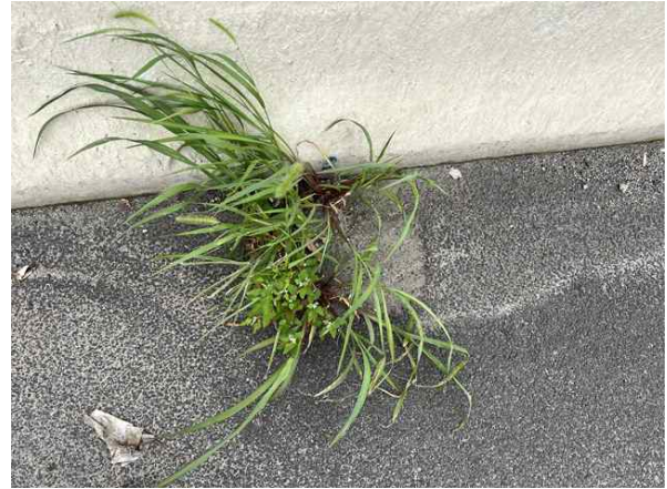
배수시설 S1 배수구 토사퇴적
