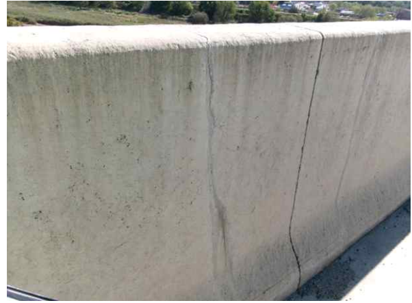
S16 방호벽 균열( C_w=0.3\text{mm} 미만)
