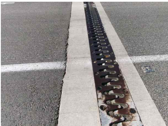
A1 후타재 균열(Cw=0.3mm미만)
