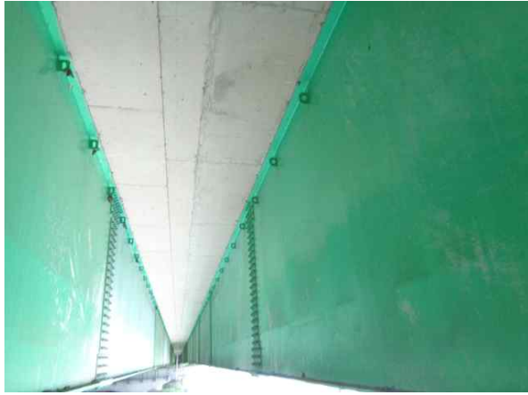
바닥판 하면 S3 상태양호
