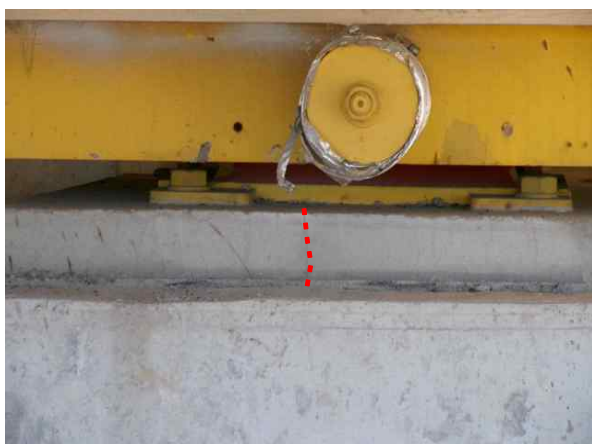
P8-Sh12 받침물탈 균열( C_w=0.3\text{mm} 미만)
