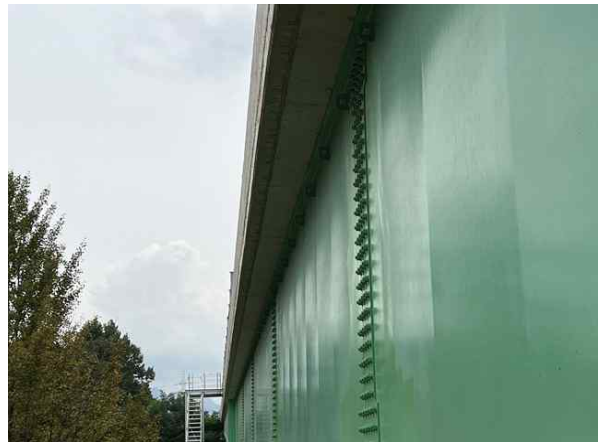
바닥판 하면 S2 상태양호
