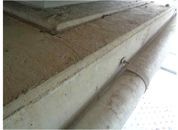
교각 P2 코핑부 균열( Cw=0.3\text{mm} 이상)
