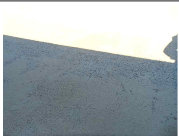
교면포장 S4 접속도로 포장박리(2.5×5.0)
