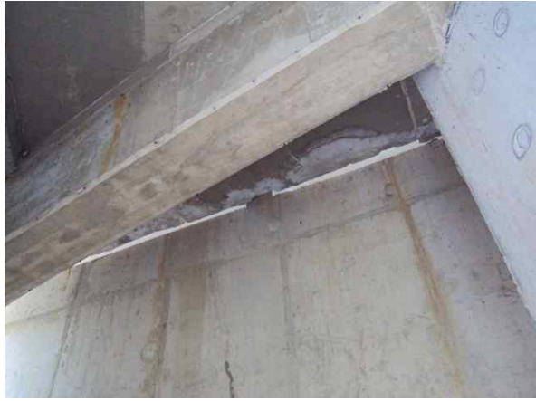
바닥판하면 S1 파손 (0.1×0.2)
