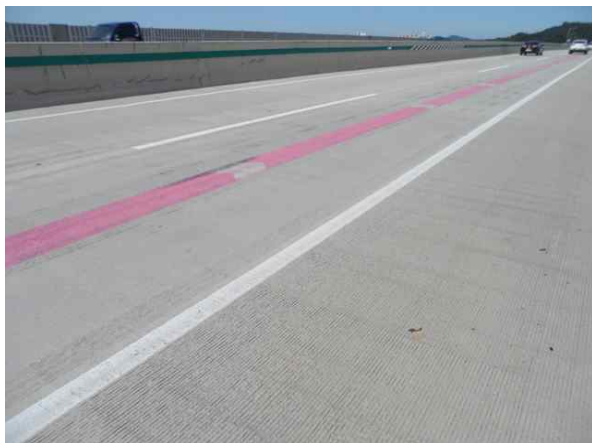
S2 포장 망상균열(35.0×3.0)
