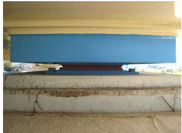
P5-Sh2 받침몰탈 균열(Cw=0.3mm미만)
