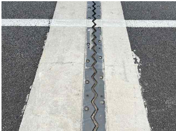
신축이음 A1 후타재 균열(Cw=0.3mm미만)
