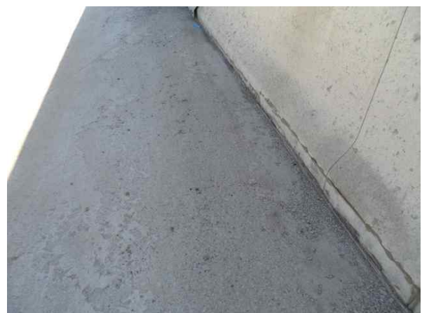
교면포장 S5 접속도로 포장박리(1.5×7.0)
