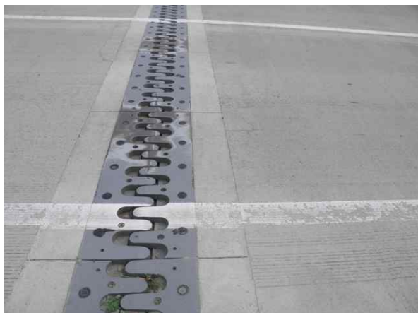
P3 후타재 균열(Cw=0.3mm미만)
