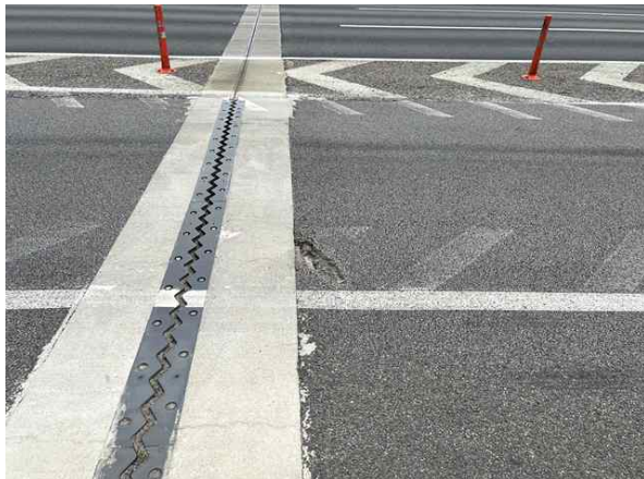
교면포장 S2 접속도로 아스콘 파손 (0.2×0.5)
