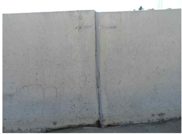
방호벽 S4 실란트파손(L=1.5m)
