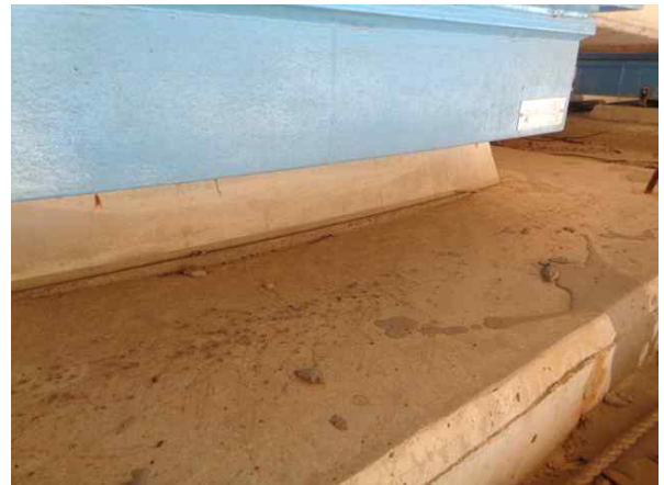
P5-Sh9 받침물탈 균열 (0.1mm/0.2m×2EA)
