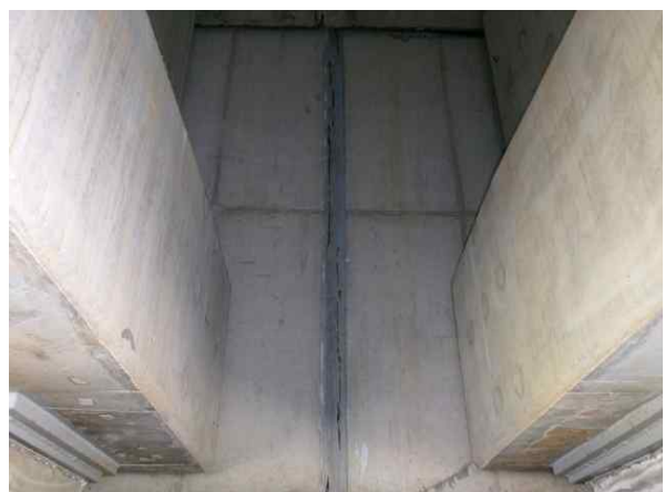
A2 실란트 파손
