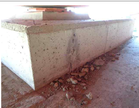
P35-Sh1 받침콘크리트 파손 (0.1m×0.3m×2EA)
