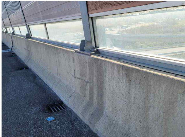
S4 균열 (0.2mm/1.5m×17EA)
