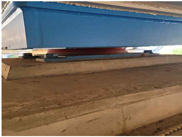
P1-Sh3 받침물탈 균열 (0.2mm/0.4m×4EA)
