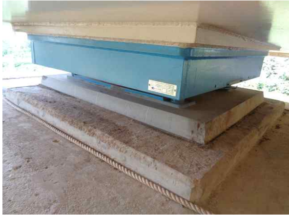
P1-Sh1 무수축몰탈 균열(0.1mm/0.2m×8EA)
