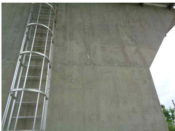
교각 P3 균열부백태(0.2×0.4)
