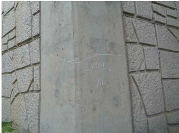
A1 구체 균열(Cw=0.3mm미만)
