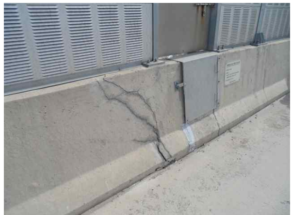
S3 접속부 방호벽 파손(1.0×1.5)
