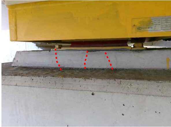
P12-Sh1 받침물탈 균열( C_w=0.3\text{mm} 미만)
