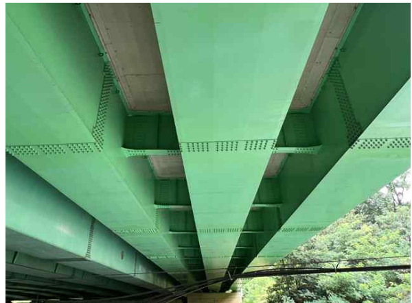
바닥판 하면 S1 상태양호
