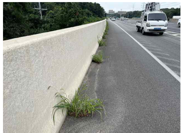
배수시설 S2 배수구 토사퇴적
