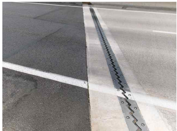
A2 후타재 균열(Cw=0.3mm미만)-서울방향
