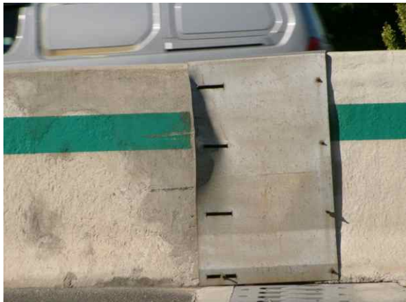
신축이음 A2 차수판 파손
