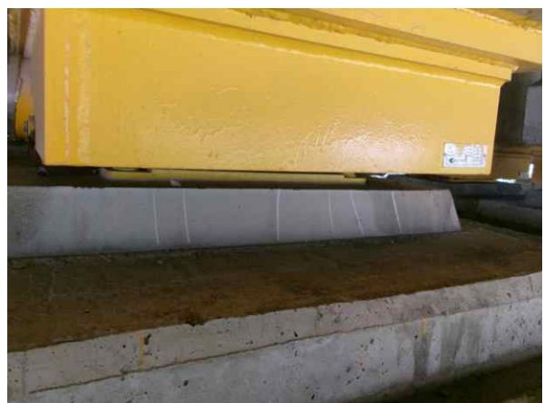
P4-Sh11 받침몰탈 균열(Cw=0.3mm미만)
