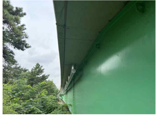
바닥판 하면 S2 상태양호
