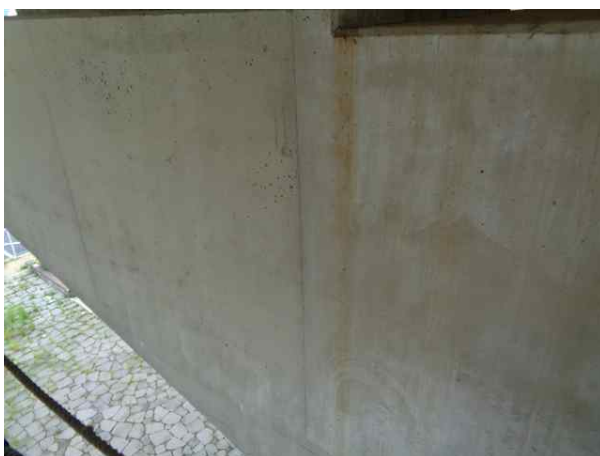
P6 코평부 균열(Cw=0.3mm미만)
