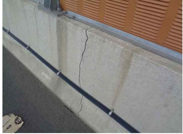
방호벽 S4 접속부 파손(0.1×1.5)
