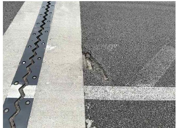
교면포장 S2 접속도로 아스콘 파손 (0.2×0.5)
