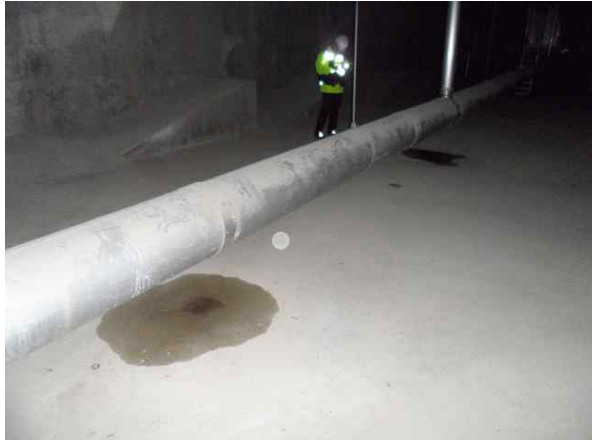
배수시설 S1 배수관 누수 3EA
