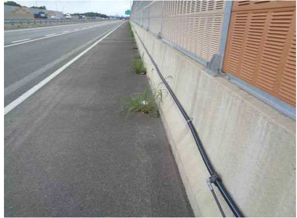
배수시설 S2 배수구 토사퇴적
