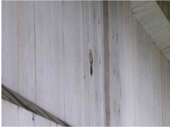
S6-G1 인양홀 파손(0.3×0.3)
