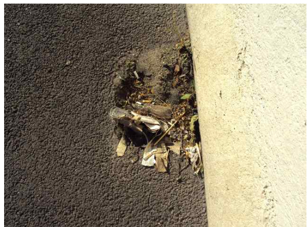
배수시설 S1 배수구 막힘(1EA)
