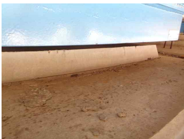
P5-Sh10 받침몰탈 균열 (0.1mm/0.2m×2EA)
