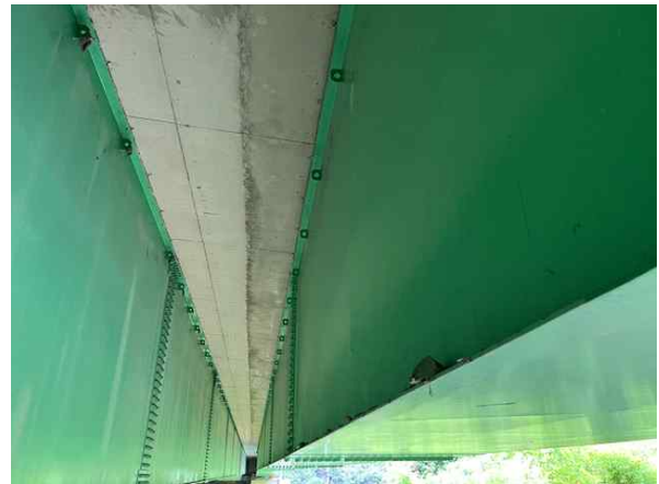
바닥판 하면 S1 상태양호
