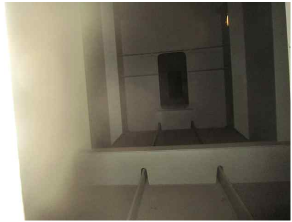
거더내부 S1-G2 상태양호
