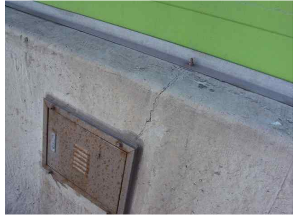
S2 방호벽 균열부 (0.3mm/0.5m)
