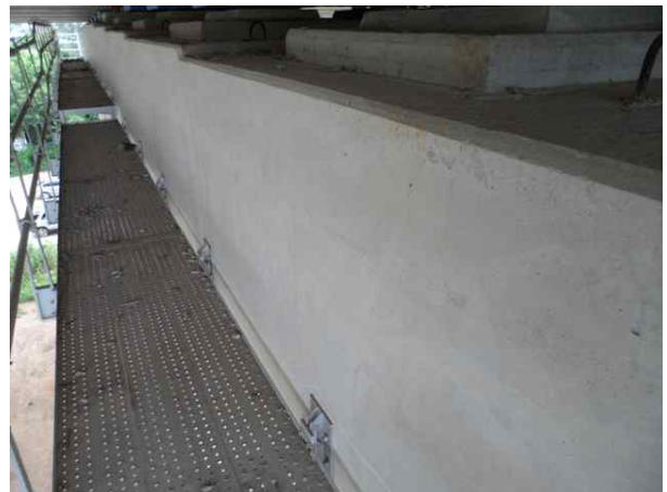
P6 코평부 균열(0.2mm/10.0m)
