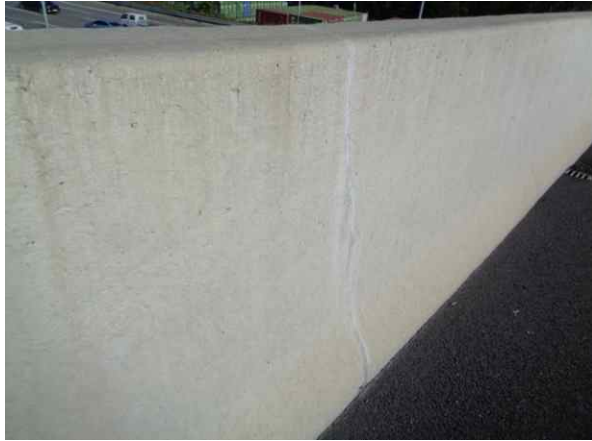
STB-S3 방호벽 균열(Cw=0.3mm미만)
