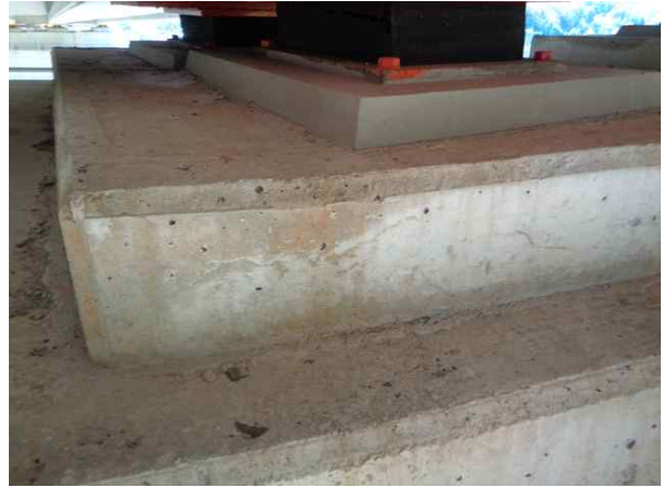
P6-Sh11 받침콘크리트 균열(Cw=0.3mm미만)
