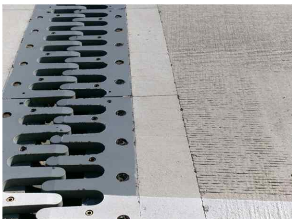
P4 후타재 균열( C_w=0.3\text{mm} 미만)
