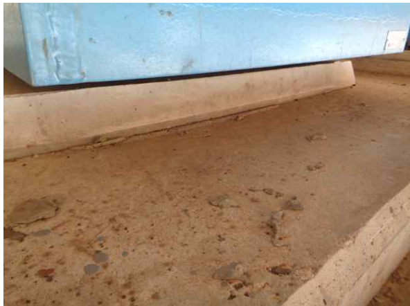
P5-Sh11 받침물탈 균열 (0.1mm/0.2m×2EA)
