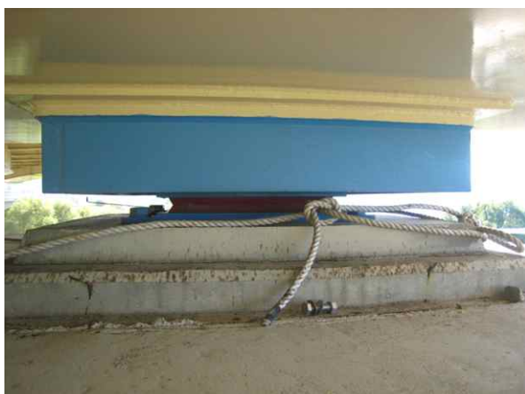
P7-Sh1 받침몰탈 균열(Cw=0.3mm미만)
