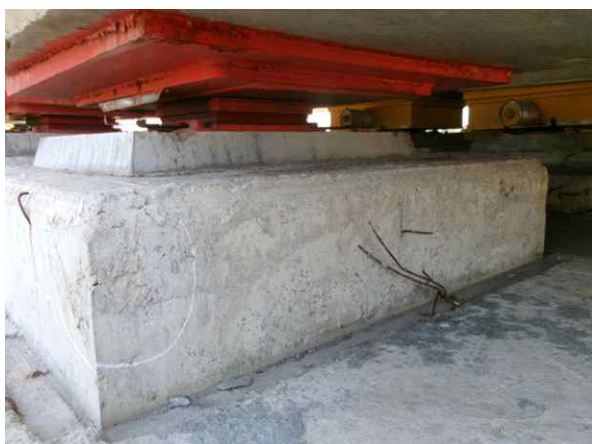
P4-Sh3 받침콘크리트 재료분리(1.0×0.2)
