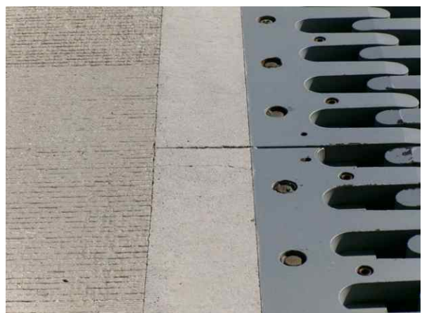
P8 후타재 균열( C_w=0.3\text{mm} 미만)
