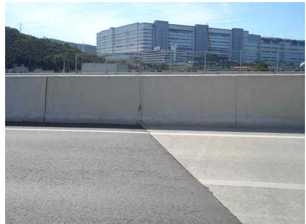
교면포장 S1 접속부아스콘 파손(0.2m×1.0m)-문산방향
