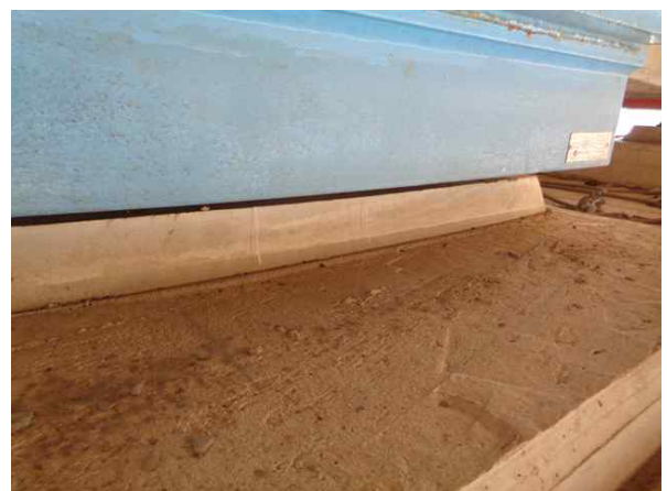
P5-Sh8 받침물탈 균열 (0.1mm/0.2m×2EA)
