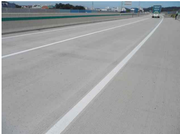
S3 교면포장 망상균열(60.0×3.0)
