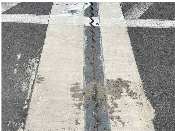
신축이음 A1 후타재 균열(Cw=0.3mm미만)
