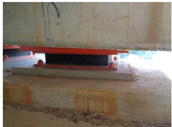
P1-Sh8 무수축물탈 균열 (0.1mm/0.2m)
