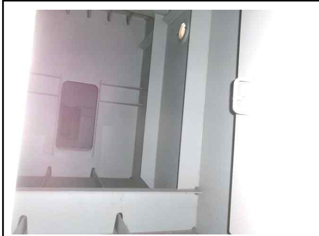
거더내부 S1-G1 상태양호
