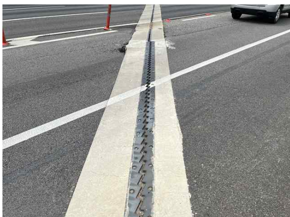
신축이음 A1 후타재 균열(Cw=0.3mm미만)
