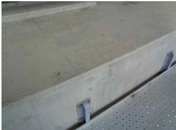
교각 P1 균열(Cw=0.3mm이상)
