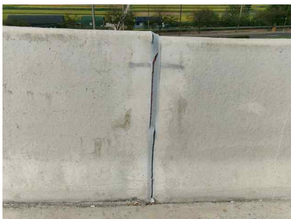
방호벽 S4 실란트파손(L=1.5m)
