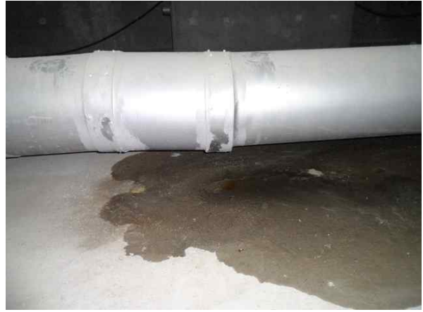
배수시설 S4 배수관 누수 1EA
