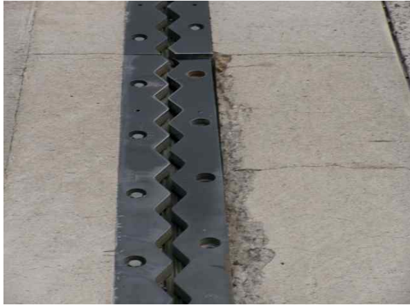
A1 후타재 파손(0.1×1.0), 본체 볼트 탈락(4EA)
