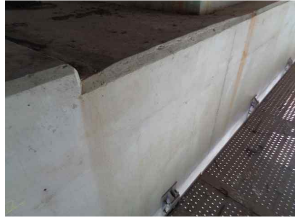
P2 콘크리트 망상균열 (8.0m×1.0m)
