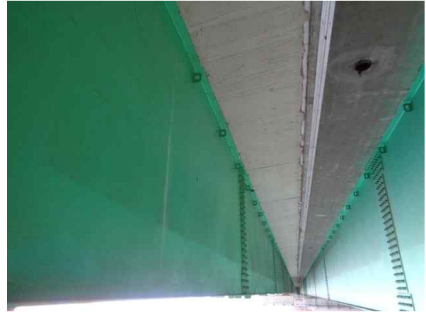
바닥판 하면 S2 상태양호
