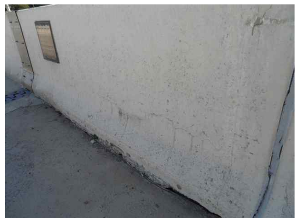
방호벽 S4 균열(Cw=0.3mm미만)
