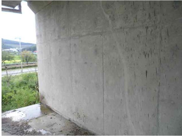
교대 A2 망상균열(3.0×2.0)
