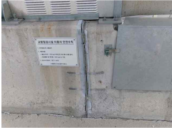
S1 접속부 실란트 파손
