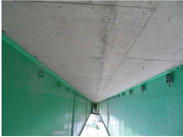
바닥판 하면 S1 상태양호
