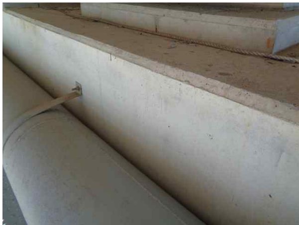
P5 코평부 균열(0.2mm/1.0m×4EA)
