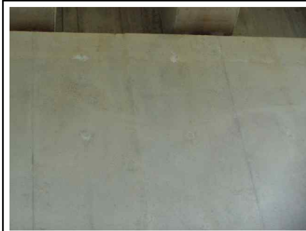
교각 P8 코핑부 균열( C_w=0.3\text{mm} 미만)
