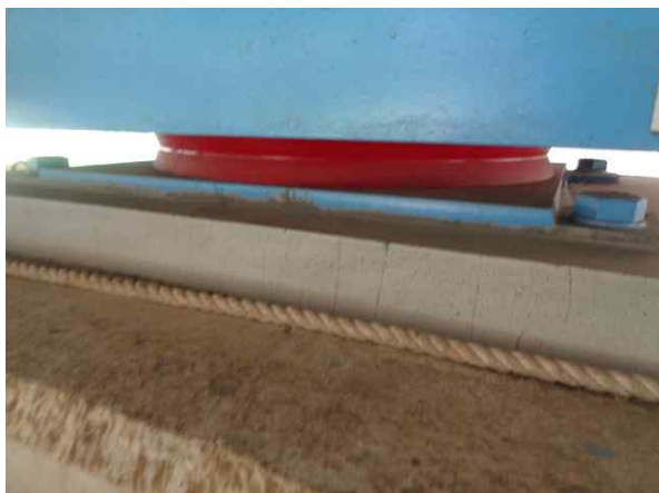
P1-Sh3 무수축몰탈 균열(0.1mm/0.2m×8EA)
