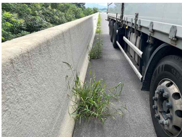
배수시설 S2 배수구 토사퇴적
