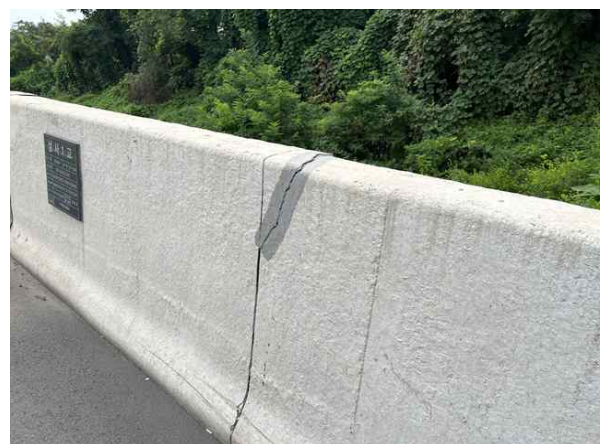
방호벽 S1 접속부 파손(0.1 × 1.5)
