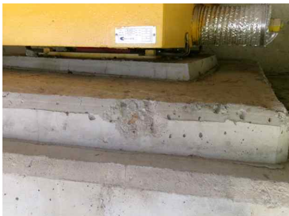
A2-Sh6 받침콘크리트 파손(0.2×0.2)
