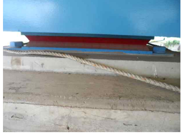
P1-Sh2 받침물탈 균열(Cw=0.3mm미만)
