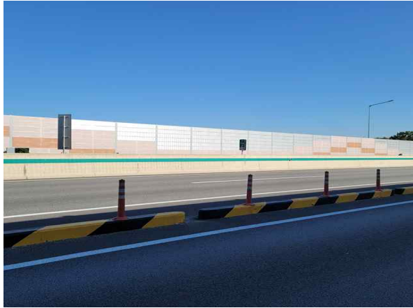
S2 균열 (0.2mm/1.5m×10EA)
