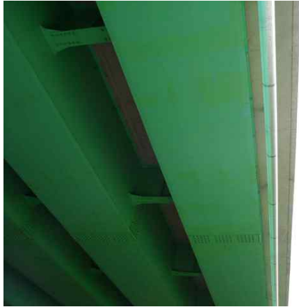
바닥판 하면 S1 상태양호
