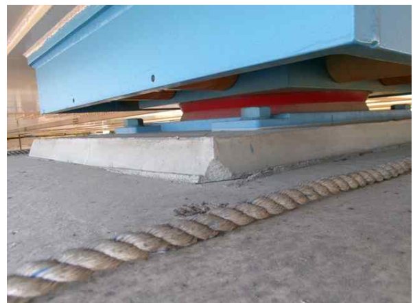
P2-Sh3 받침몰탈 파손 (0.1m×0.1m)
