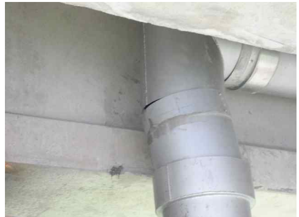
배수시설 S13 배수관 이음부 불량(1EA)
