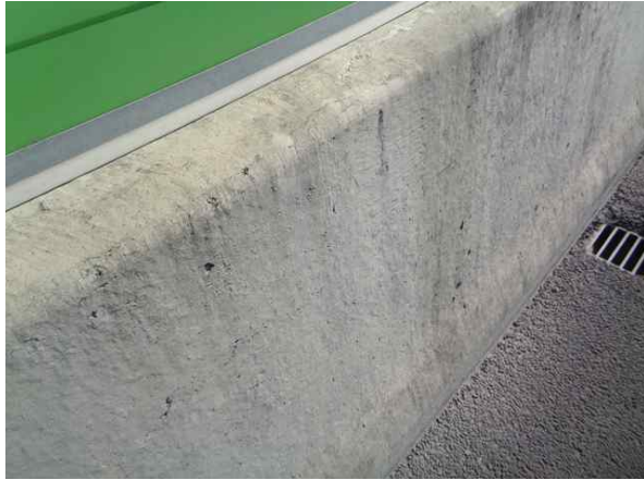
S2 방호벽 균열부 (0.2mm/7.0m)
