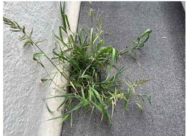
배수시설 S1 배수구 토사퇴적
