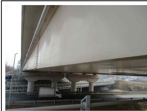
거더외부 상태양호 - 22년 상반기
