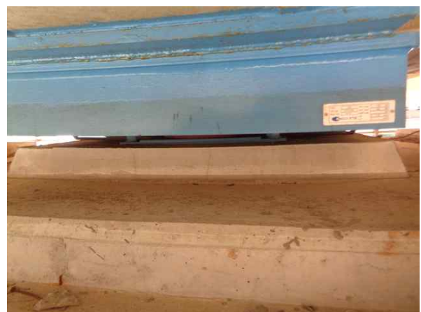
P5-Sh3 받침물탈 균열 (0.1mm/0.2m×2EA)
