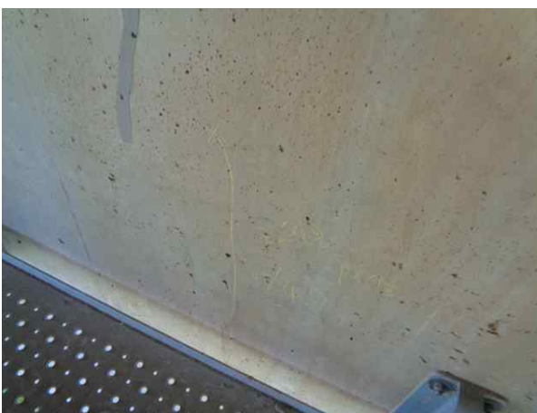
P3 코평부 균열(Cw=0.3mm미만)
