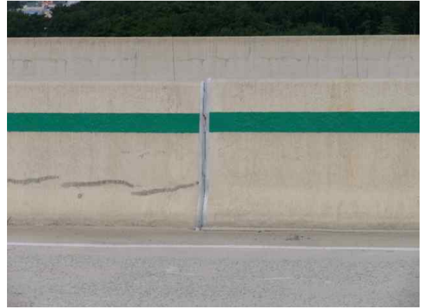
S1 접속부 실란트 파손
