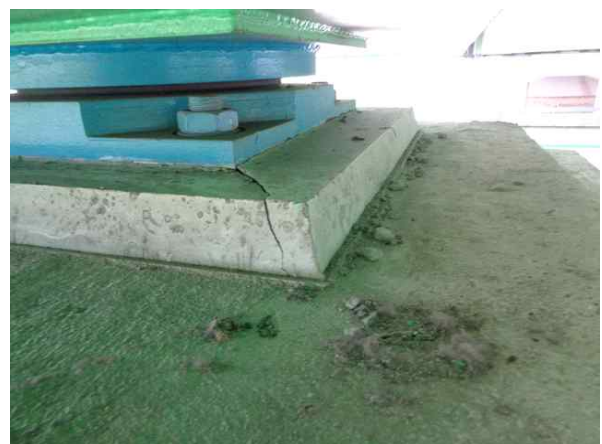
교량받침 P2-Sh1 받침물탈 파손( 0.2 \times 1.0 )
