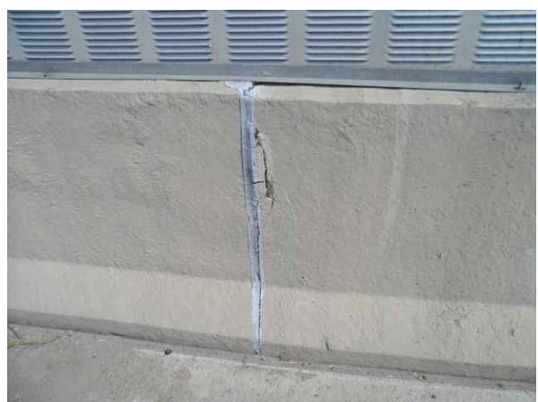
S2 접속부 방호벽 파손(0.1×1.5)
