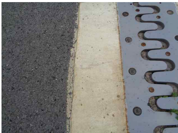
신축이음 A1 후타재 균열( Cw=0.3\text{mm} 미만)
