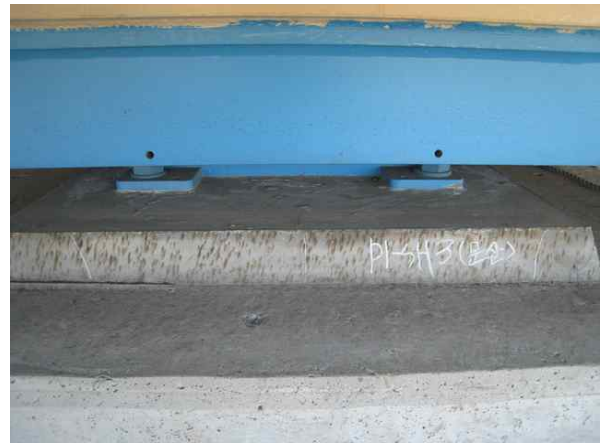
P1-Sh3 받침몰탈 균열 (0.1mm/0.1m×3EA)
