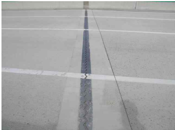
A1 후타재 균열 (Cw=0.3mm미만)
