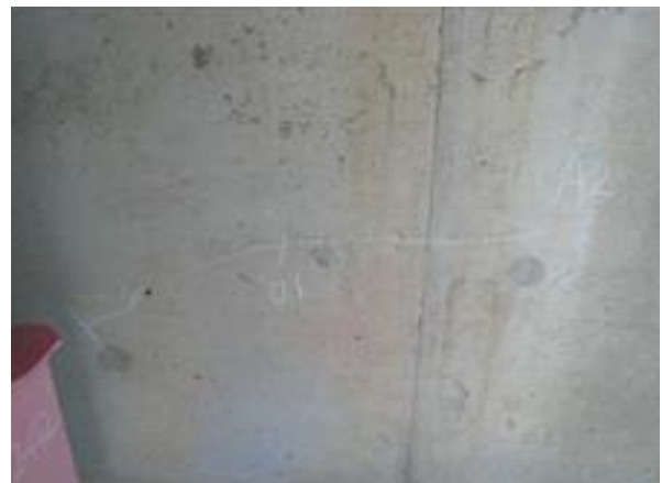
A2 균열(폭 0.2mm/1.0m)
