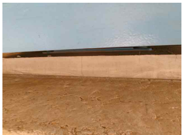
P4-Sh8 받침물탈 균열 (0.2mm/0.2m×2EA)
