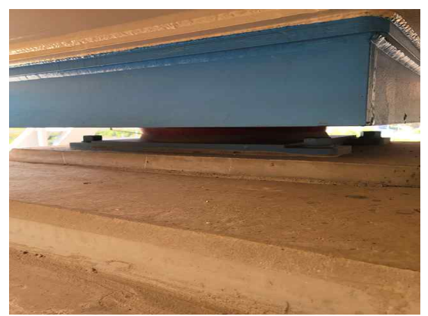
P1-Sh1 받침물탈 균열(0.2mm/0.4m×5EA)
