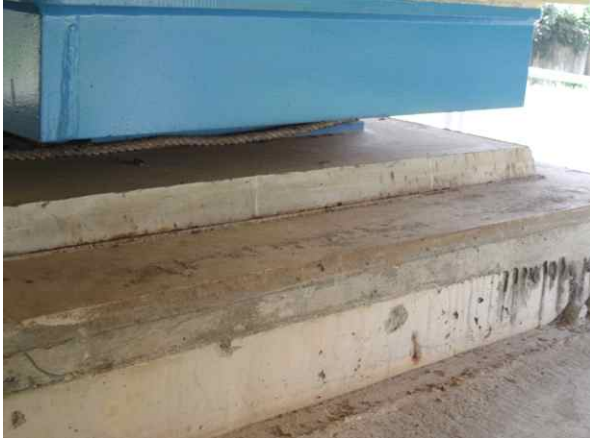
P1-Sh1 받침물탈 균열(Cw=0.3mm미만)
