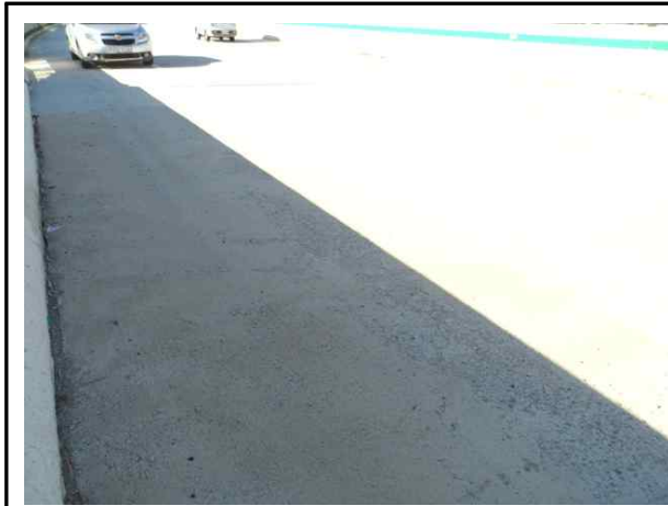
교면포장 S4 접속도로 포장박리(2.5×5.0)
