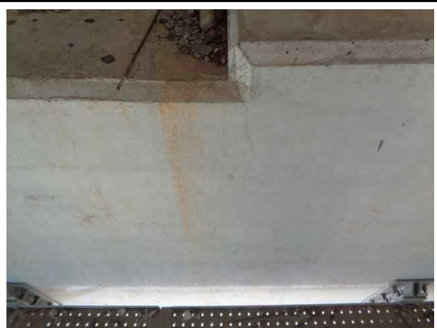
P5 코평부 균열(0.2mm/2.0m×4EA)
