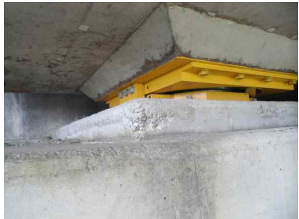
A2-Sh1 받침콘크리트 재료분리 (0.6×0.2)
