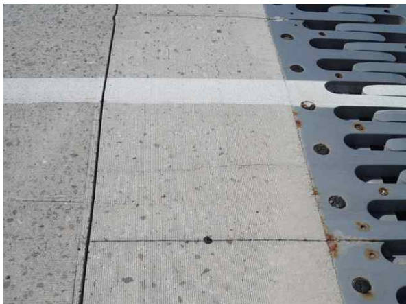
신축이음 A1 후타재 균열 (Cw=0.3mm미만)
