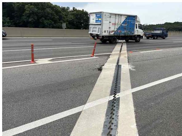
교면포장 S1 접속도로 아스콘 파손(0.3×1.0)
