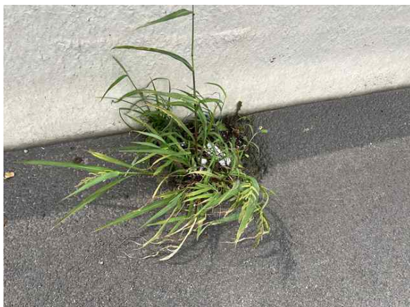
배수시설 S2 배수구 토사퇴적
