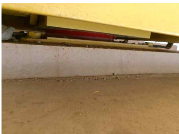
P3-Sh8 받침물탈 균열 (0.2mm/0.2m×2EA)
