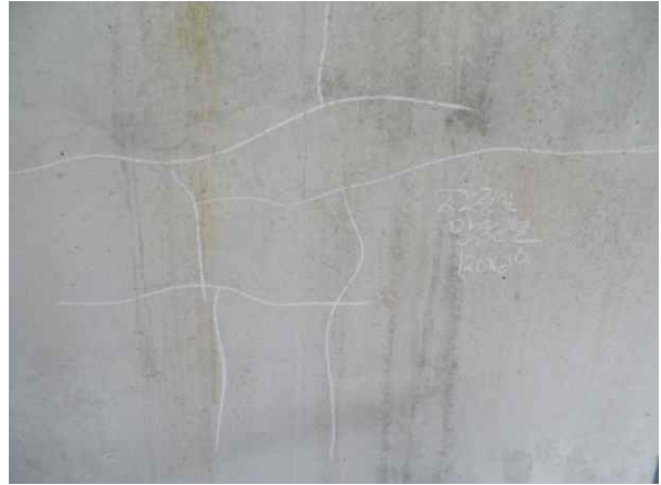
교각 P5 코핑부 망상균열(12.0×2.0)
