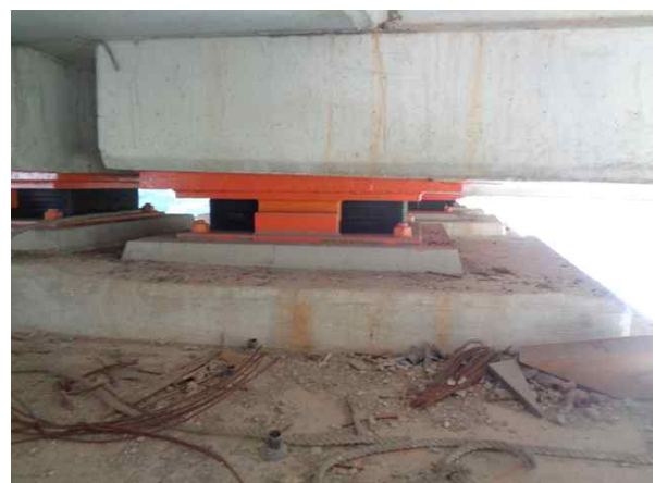
P1-Sh11 무수축물탈 균열 (0.1mm/0.2m)
