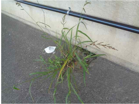
배수시설 S1 배수구 토사퇴적
