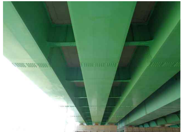
바닥판 하면 S4 상태양호
