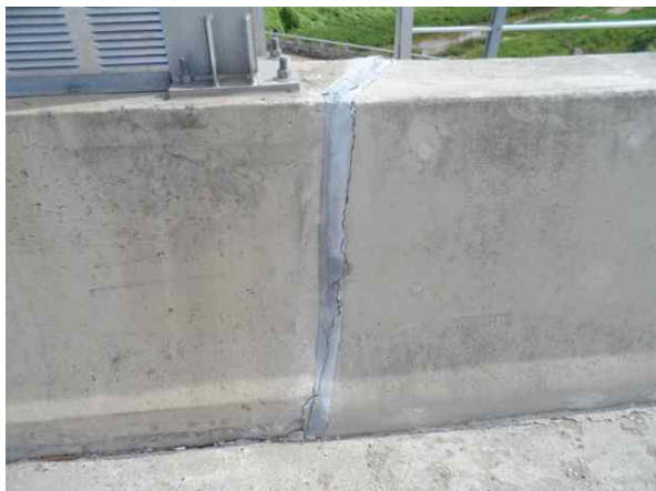
S1 접속부 방호벽 파손(0.1×1.5)
